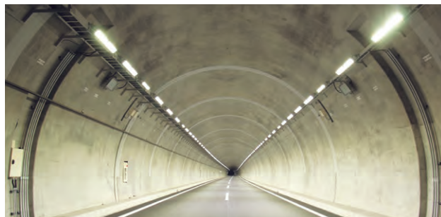
トンネルLED灯
